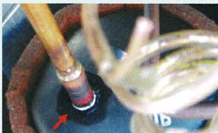
油漏れやしみで漏えいを確認
